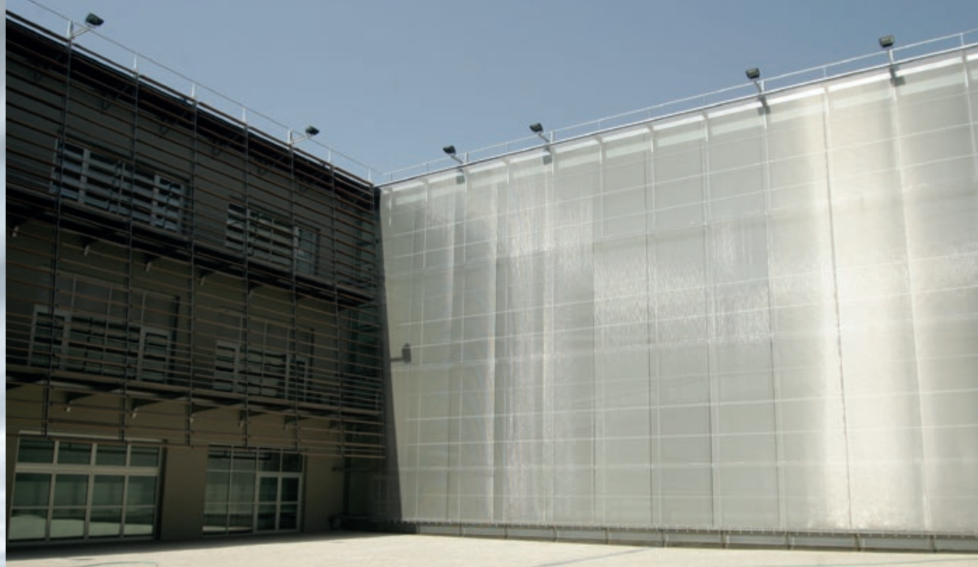
Pare-vue le jour. Façade en maille métallique EGLA-TWIN 4253, musée Benaki à Athènes, Grèce.
