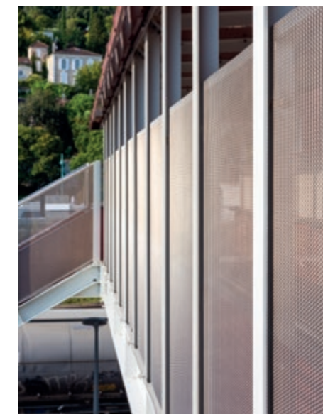
Revêtement de garde-corps semi-transparent en ECLA-DUO 4222. Gare d'Agen, France.
