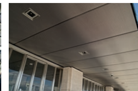
Revêtement de plafond composé d'éléments de cadre. ECLA-MONO 5031, Stade Krasnodar, Russie.
