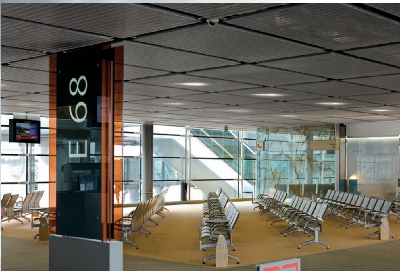
La toile de qualité architecturale garantit un fonctionnement optimal des installations d'aération et des sprinklers. Terminal S3, aéroport de Roissy Charles de Gaulle, Paris, France, DOGLA-TRIO 1010.
